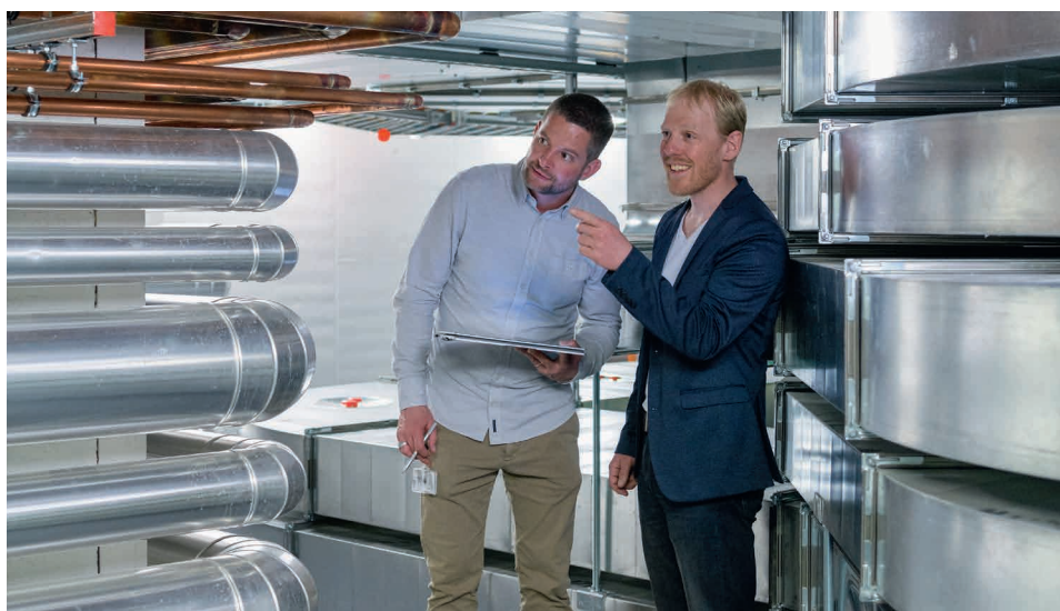
Une gestion efficace de l'énergie grâce aux échanges réguliers entre Mark Schuppli (à droite), conseiller AEnEC, et Benjamin Schwarz, chef de service à l'hôpital de l'Île à Berne.
