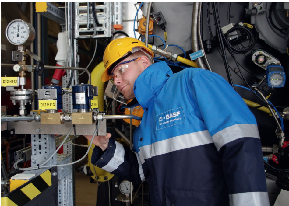
Vier neue Dampfkessel tragen am Standort Kaisten zur Steigerung der Energieeffizienz bei.
