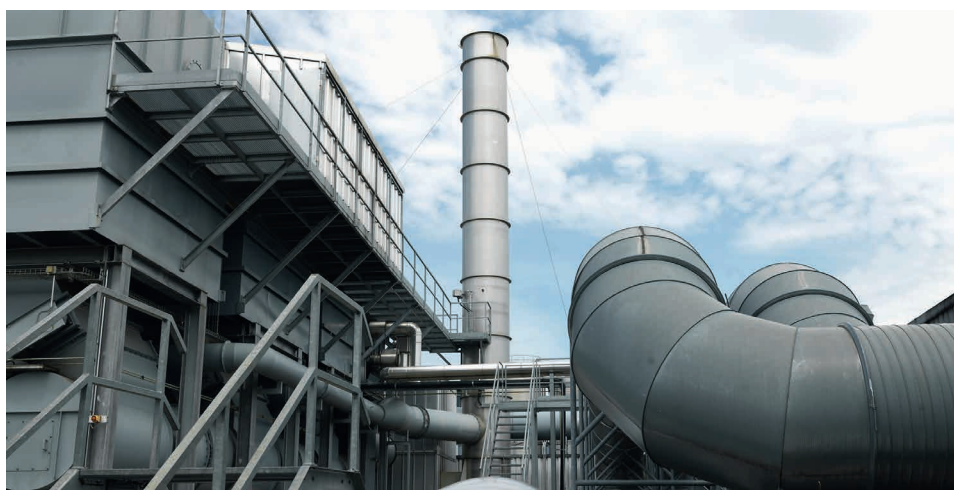
L'installation de traitement de l'air de Wipf SA est au cœur du dispositif d'amélioration de l'efficacité énergétique.
