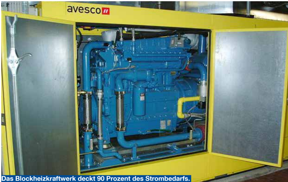
Das Blockheizkraftwerk deckt 90 Prozent des Strombedarfs.
