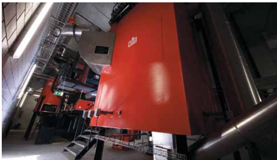
La centrale à biomasse produit la vapeur nécessaire aux processus
