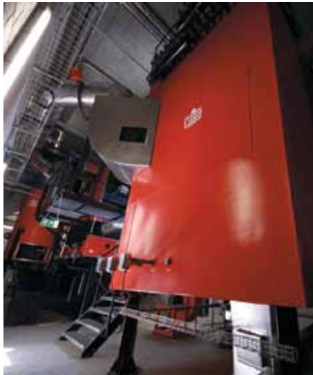
Die neue Biomasse-Energiezentrale zur Produktion von Prozessdampf
